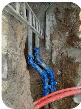
Rnvt de 350 ml de DN 125 fonte canalisation ( PMA )
