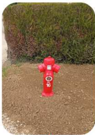
Amélioration Défense Incendie ( commune )
