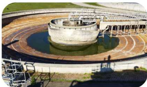
Vidange du clarificateur
